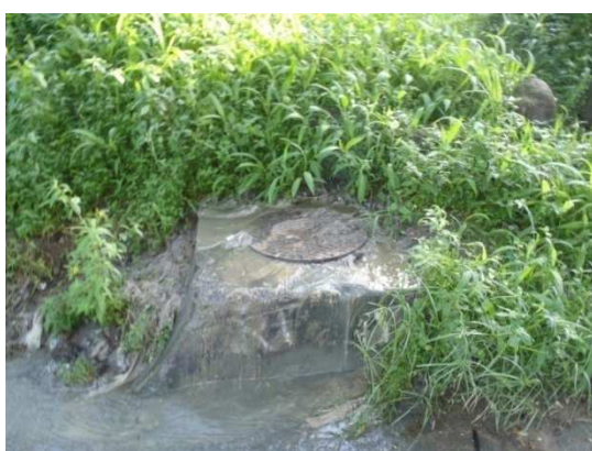
Regard d'une canalisation d'eaux usées débordant lors d'un épisode pluvieux
