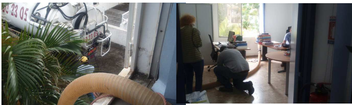
Désobstruction des toilettes à l'ODE par un vidangeur agréé ayant suivi cette formation
